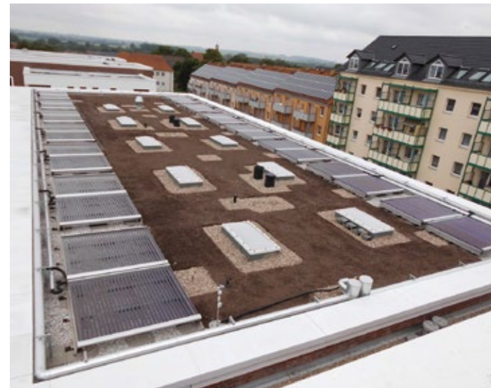
Thermische Solaranlage für Heizen und Kühlen, ca. 100 kWp Leistung, 136 m 2 Kollektoren mit Vollvakuumröhren, 2 Kältemaschinen à 15 kW in Prenzlau, Neue Mitte, Quelle: AkoTec
