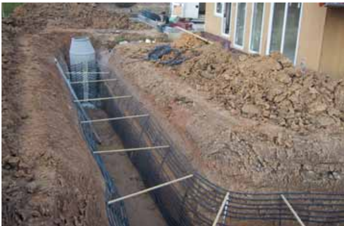
Erdaufschlüsse für Kollektoren (hier Grabenkollektor) müssen nur angezeigt werden, wenn eine Beeinträchtigung des Grundwassers zu erwarten ist Quelle: Fa. SBK GmbH, Neuenstein
