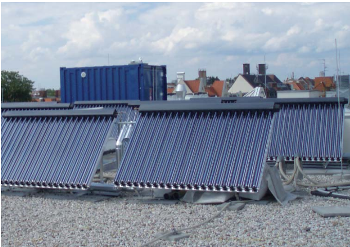
Röhrenkollektoren einer innovativen solaren Kühlanlage zur Klimatisierung eines Ärztehauses
